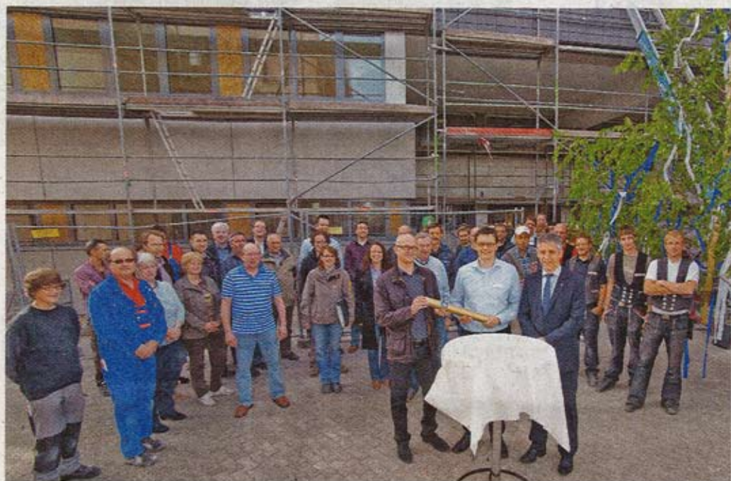
Richtfest für den OP-Anbau am Bruderkrankenhaus: Technischer Leiter Markus Jordan (Mitte) übergibt die Grundsteinkapsel an den Architekten Tom Naujack. Rechts steht Siegfried Rörig, Kaufmännischer Direktor des Krankenhauses. Foto: Gerd Vieler
